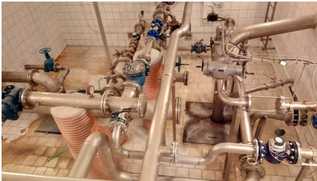
Vodovodné potrubie v priestoroch vodojemov
